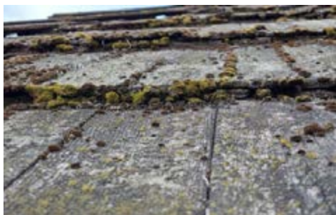
Foto 24. Șindrila pe latura de nord pu-tregai și licheni
