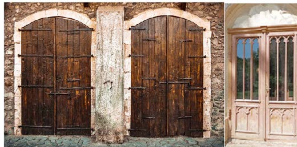
Foto 6. Elementele de feronerie exterioară
