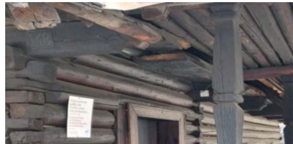
Foto 14. Desprinderea grinzilor din zona intrării în casă
