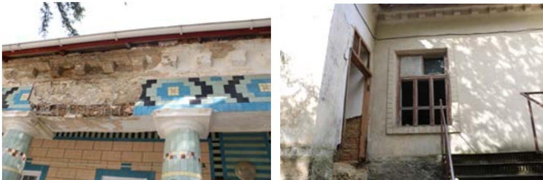
Starea avansată de degradare a conacului Donici din satul Dubăsarii-Vechi
