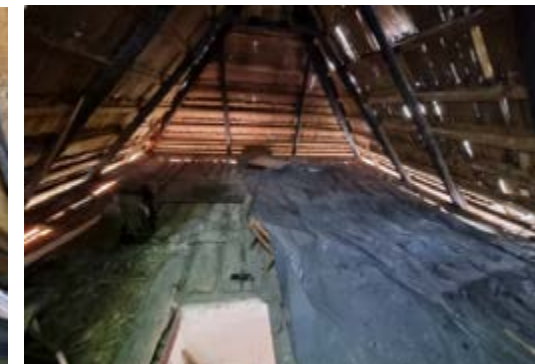
Foto 19. scânduri fracturate și deformate, depuneri de murdărie aderentă, lacune ale dranițelor din învelitoare
