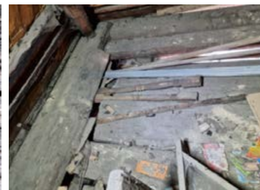
Foto 21. Cosoroabă dislocată la îmbinarea de colț, depozitare de materiale neadecvate, murdărie, rumeguș de la atac insecte xilofage masiv, urme atac fungic
