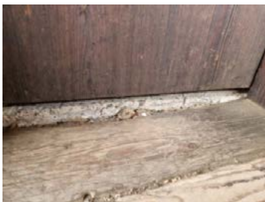
Foto 28. Podeaua foișorului prezintă uzură funcțională, urme de atac fungic și de insecte xilofage
