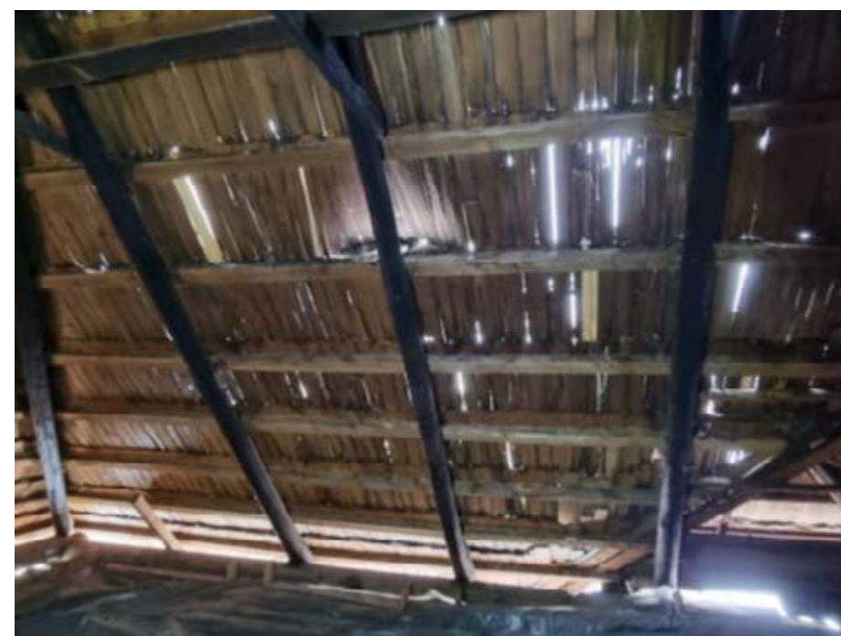
Foto 15. Dranițe crăpate cu lacune în zona fumăriței
